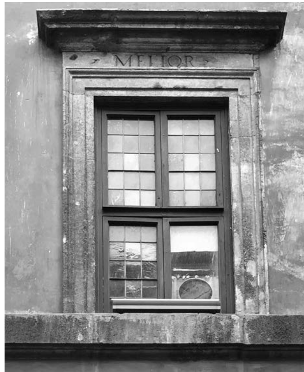
FIG. 10. A. da Sangallo il Giovane, finestra del primo piano di palazzo Sangallo-Medici-Clarelli in via Giulia, quarto decennio del XVI secolo.
